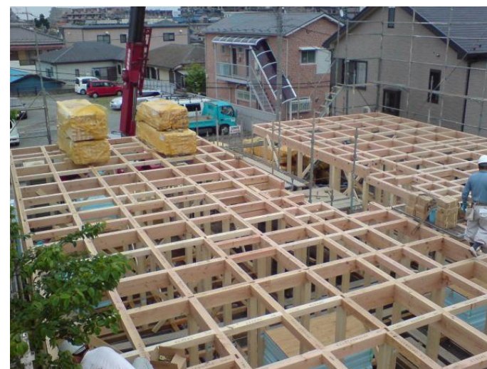
格子状に組み込まれた大梁と小梁。写真奥に見えるのは、これから張り付ける厚さ24mmの構造用合板
