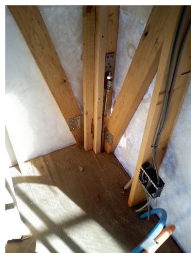
地震時の柱と土台の浮きを防止するために、アンカーで基礎に固定
